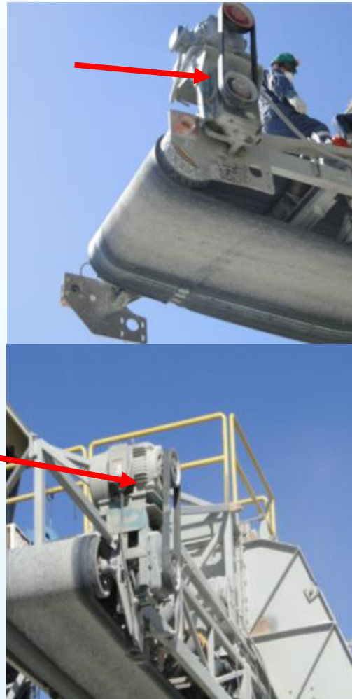
Figura 8. Transmisiones en equipo de banda cruzada, apilador de terreros.
