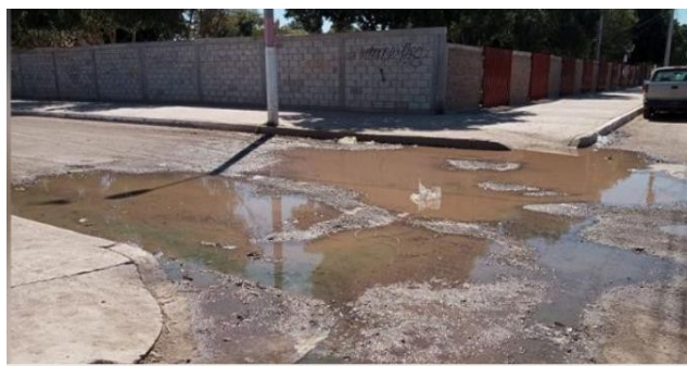
Figura 1. Ejemplo del estado en que se encuentran algunas de las calles vistas en la colonia campestre.
